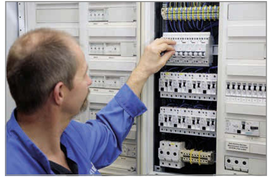
Bild 1: Verteilerschrank einer Elektroinstallation mit Schutzschaltern www.siemens.com
