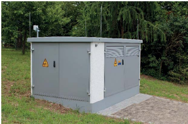
Bild 4.5 Intelligente Ortsnetzstation mit äußerem Blitzschutz
