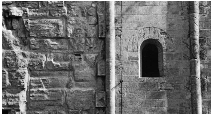
Fassadenteile der Turmwestfront. Die rechte (südliche) Seite wurde offen- sichtlich mit glatten Quadern erneuert, die Arbeiten aber nach links nicht fortgesetzt. Foto: Pötschke, 2003
