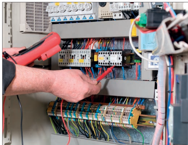
Bild 1: Spannungsmessung an einem Hilfsschütz
