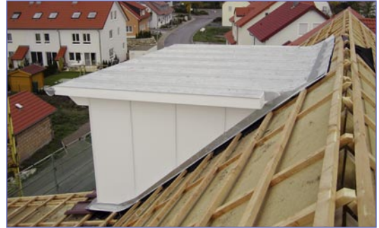
Bild 2: Dachgaube mit Farbaluminium (weiß) und Titanzink in den Randeinfassungen
