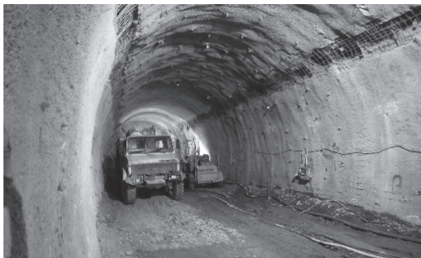
Bild 21. Schlitz in der Spritzbetonschale beim Vortrieb in der Kramerüberschiebung
