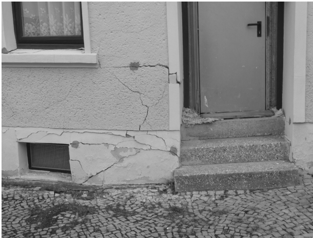
Bild 1.1 Risse an einem Wohngebäude infolge von Untergrundverformungen
