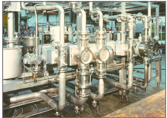
Bild 1: Rohrleitungen in einer Chemieanlage
